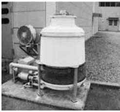
図2 クーリングタワーの例
