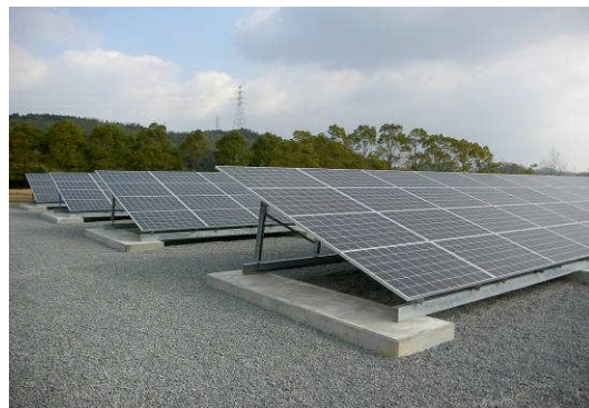
出力100kWの発電施設
