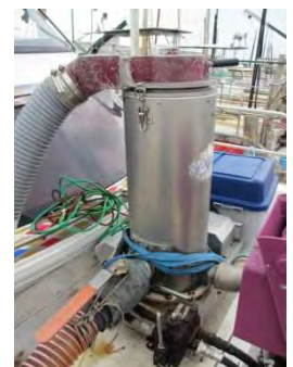
写真3 ポンプ, 油水分離機
