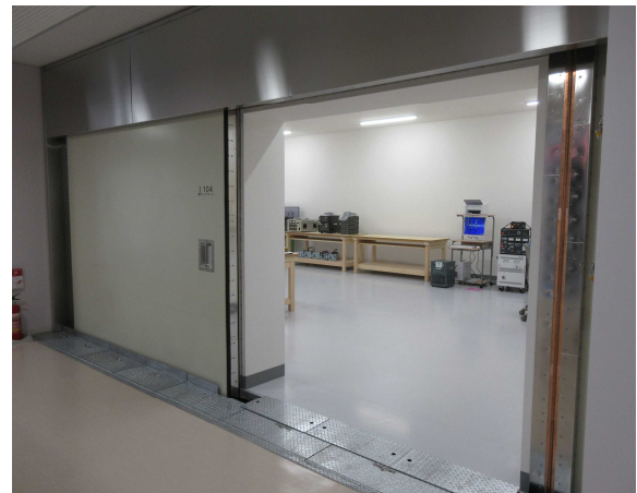
磁気シールドルーム
